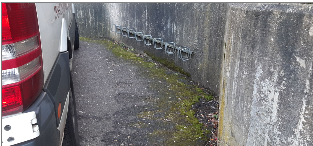
Abb. 8: Radabstellanlage Rathausmarkt (zugeparkt, veraltet, beschädigt, nicht überdacht)
